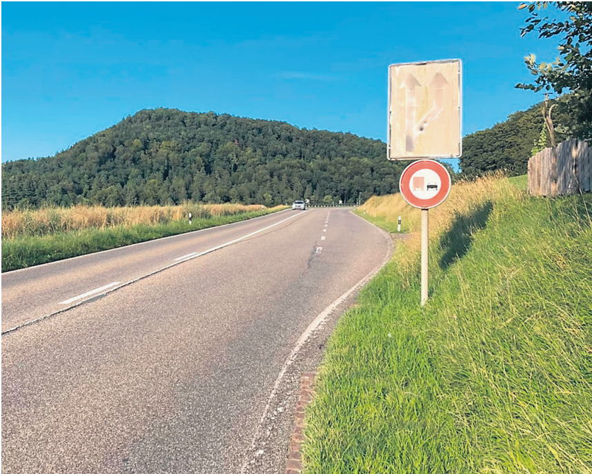
Die Beläge der Bözbergstrasse sind zum Teil über dreissigjährig und müssen erneuert werden.
